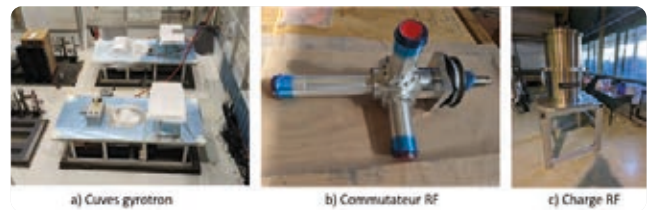
Figure 2 : Composants déjà installés (a) ou qui seront installés sur la plateforme ECRH (b) (c)
